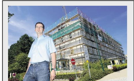
ASB-Geschäftsführer Alexander Penther lässt das Verwaltungsgebäude in Neustadt komplett umbauen. Darin entsteht ein Kompetenzzentrum für Demenzkranke. Sie und ihre Angehörigen sollen hier Hilfe bekommen. Foto: Steffen Unger
